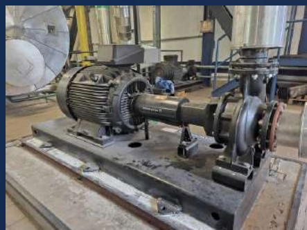
VDG elektromotora a čerpadla
