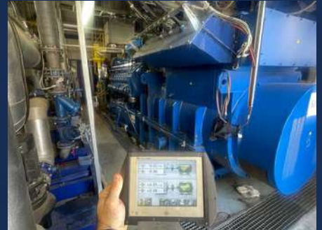
Ustavenie kogeneračnej jednotky
