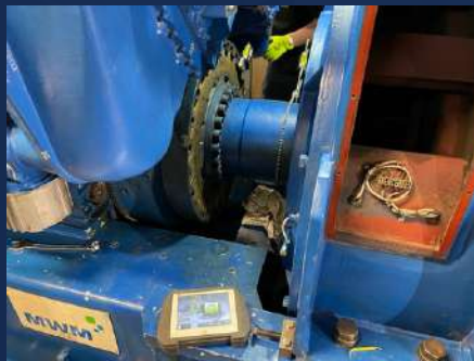
Ustavenie kogeneračnej jednotky
